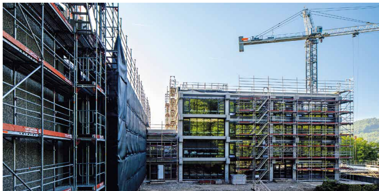
Flexibilität à la Roth Gerüste: Für die Besichtigung durch die Bauherrschaft wurde ein Teilbereich abgerüstet. Die Sicherheit bleibt top.
